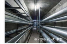
ライフラインの更新 停電による研究成果の消失や配管破損による危険物の流出を防止
