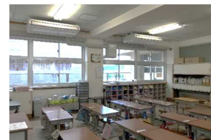
空調設備・換気設備を備えた教室
