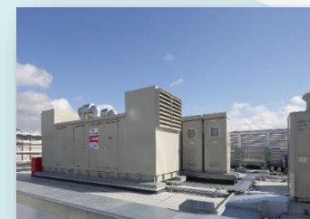
屋上に設置した自家発電設備
