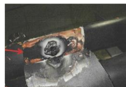
特別高圧ケーブル故障
